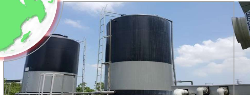
RO water reuse
